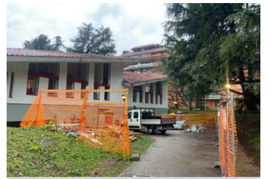
IL CANTIERE ALLE SPALLE DELLA MATERNA La nuova ala si trova nel plesso della Scuola dell'Infanzia Sabin Milano2, tra le scuole Grimm e Collodi.
