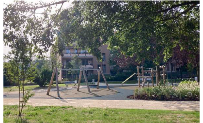
L'area giochi del nuovo giardino in fase di completamento (ancora chiusa al pubblico). In basso, il cantiere in via Gran Paradiso e la nuova area cani
