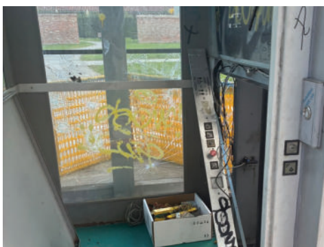
Lo stato fatiscente di un ascensore, vandalizzato, sotto il ponte di Lavanderie
