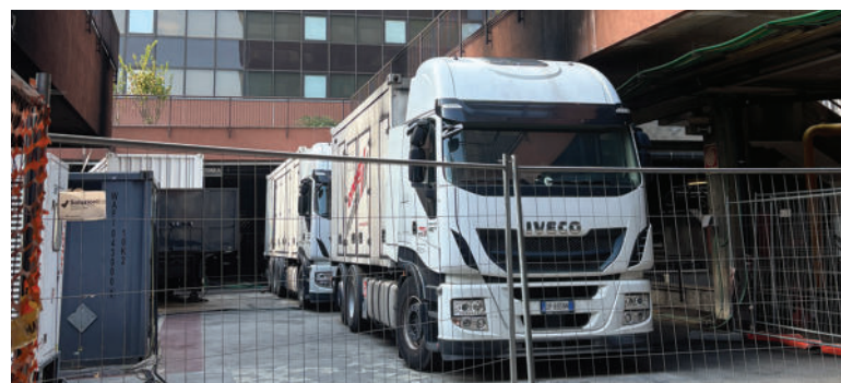
Qui sopra, uno dei gruppi elettrogeni in funzione per alimentare l'impianto elettrico del centro, messo fuori uso da un allagamento
